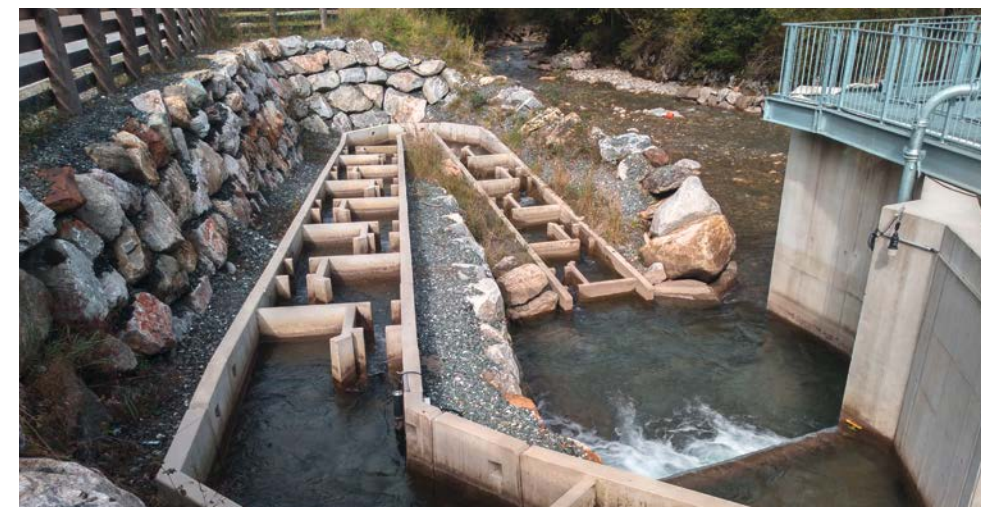
Technische Fischwanderhilfe in Form eines „Vertical Slot Fish Pass“ beim Kraftwerk Hermann & Müller KW an der Fuscher Ache
